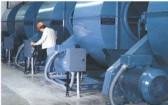
Figur 18.6 Elektriske motorer montert på strammeskinner for reimdriфт av store vifter
