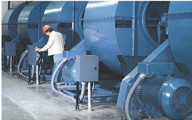
Figur 15.6 Elektriske motorer montert på strammeskiner for reimdrift av store vifter
