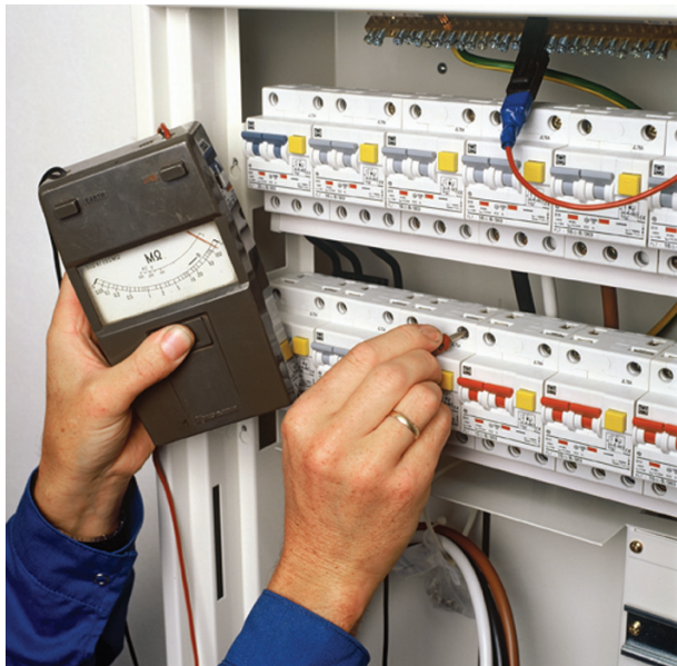
Figur 1.16 Måling av isolasjonsresistansen
