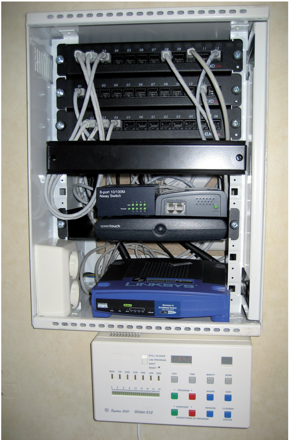
Figur 4.12 Tele og dataskap i en bolig (under skapet sitter styringen av varmen i boligen)
