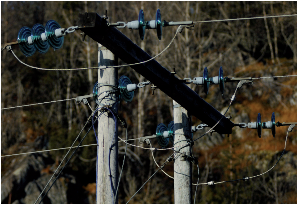
Figur 8.3 Mast til lokalnett
