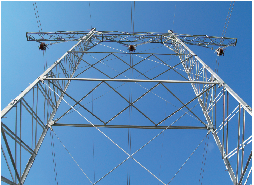
Figur 8.1 Mast til sentralnett
