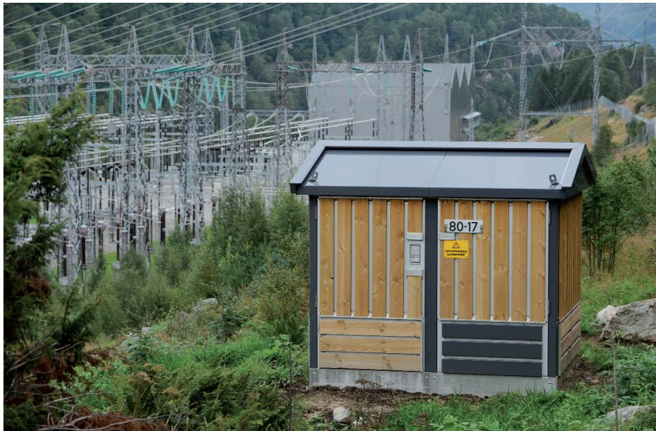
Figur 8.6 Transformatorkiosk for et boligfelt, og i bakgrunnen en fordeling for et distrikt
