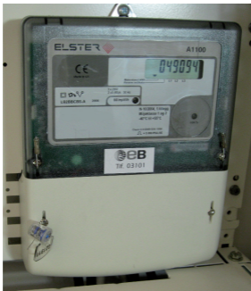
Figur 9.12 Energimåler montert i et fordelingssskap
