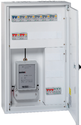
Figur 9.2 Ferdig installert fordelingskap
